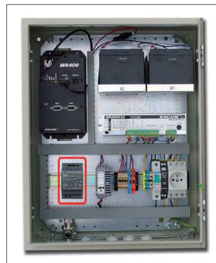
Obr. 3. Napájecí zdroj HDR v rozváděči
